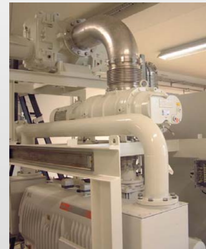
Stations de pompage des bains hélium
