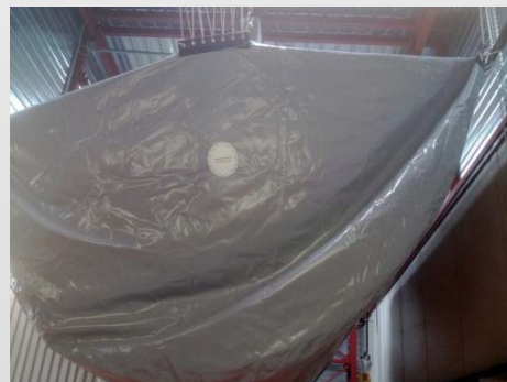
Volumes tampons : Baudruches (30, 80 & 90 m 3 )
